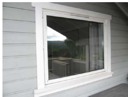
H vindu med 3 lag glass.
