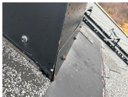
Pipebeslag er skjøtet på noe.
