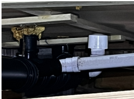
Durgoventil for kloakklufting plassert under hytten
