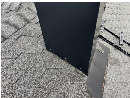
Noe rust på sokkel beslaget på pipen.
