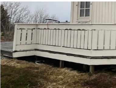
Kledning på kant av gulv er stedvis slitt.
