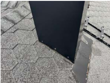
Noe rust på sokkel beslaget på pipen.
