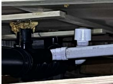
Durgoventil for kloakklufting plassert under hytten
