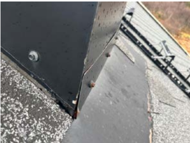
Pipebeslag er skjøtet på noe.
