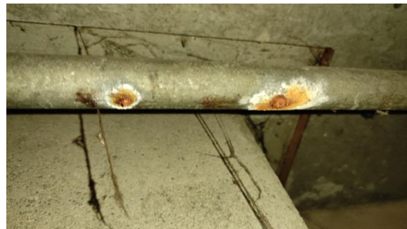
Rustdannelser på jernrør.
