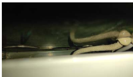
Utett hull i sikringsskap.
