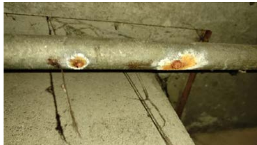
Rustdannelse på jernrør.
