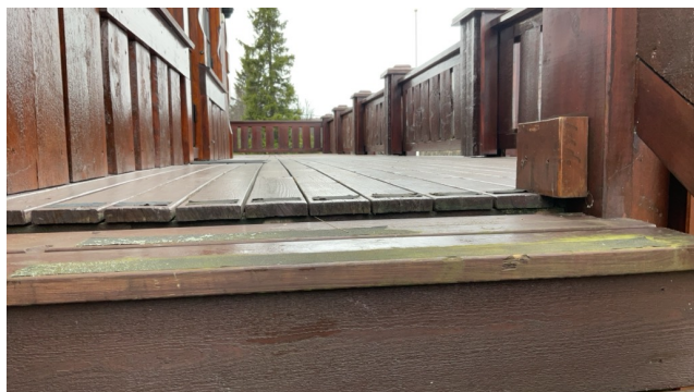
Skjevhet i terrasse
