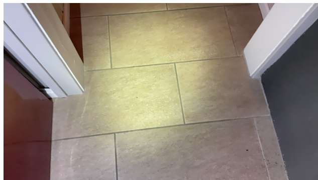
Bom (hullrom) i flis ved overgang gang og kjøkken, sprekke dannelse i fuge
