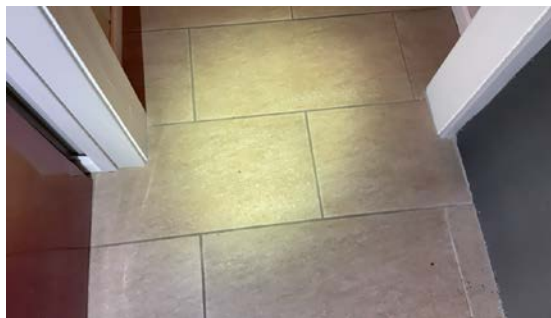
Bom (hullrom) i flis ved overgang gang og kjøkken, sprekkdannelse i fuge
