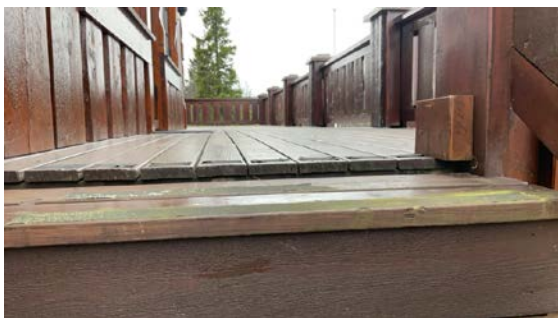
Skjevhet i terrasse
