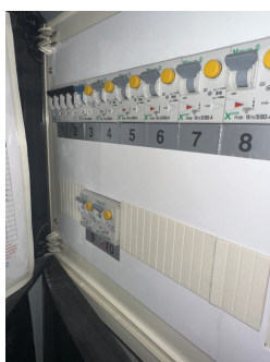
Sikringsskap med automatsikringer.
