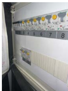
Sikringsskap med automatsikringer.
