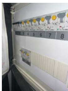
Sikringsskap med automatsikringer.
