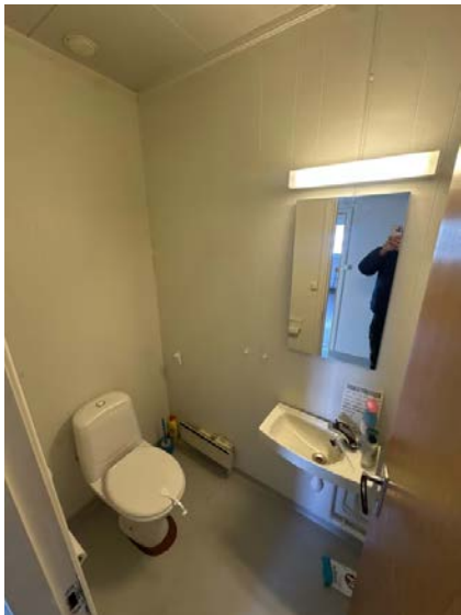
Viser toalettrom. Noe manglende maling på gulv rundt toalett.
