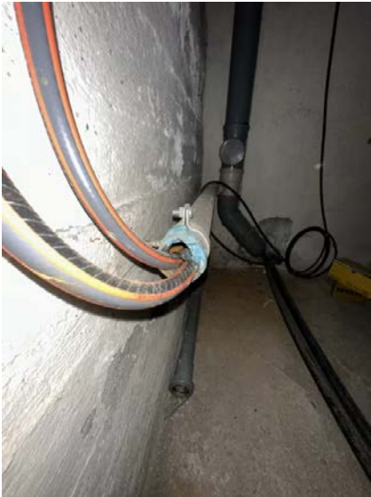
Viser utettheter ved avløpsanlegget. Lukt fra avløpsanlegget antatt fra utettheter.
