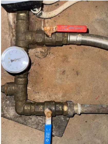
Viser irr og rust på kraner.
