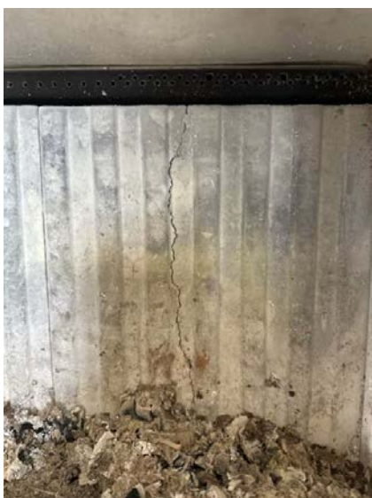
Viser sprekk i innvendig ovn i stue.
