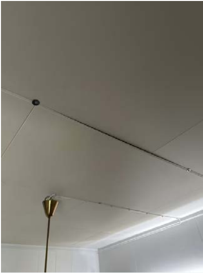
Viser løse himlingsplater på soverom i 1.etasje. Plater midlertidig festet.
