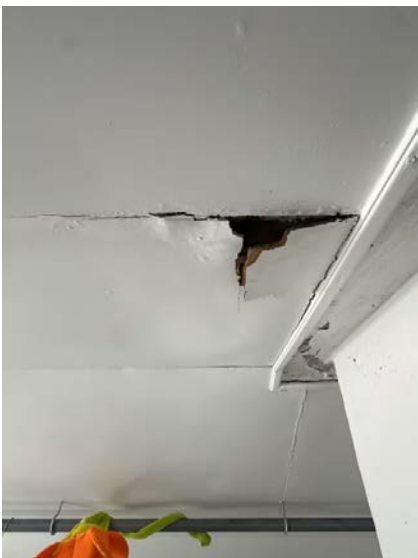
Viser skader på soverom i 2.etasje etter tidligere lekkasje.
