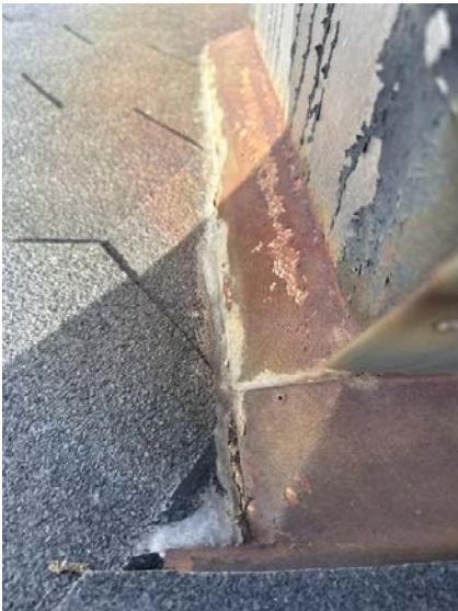
Viser rust på beslag.
