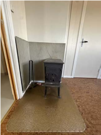
Viser ildsted på kjøkken. Det registreres sprekk i eternittplate.
