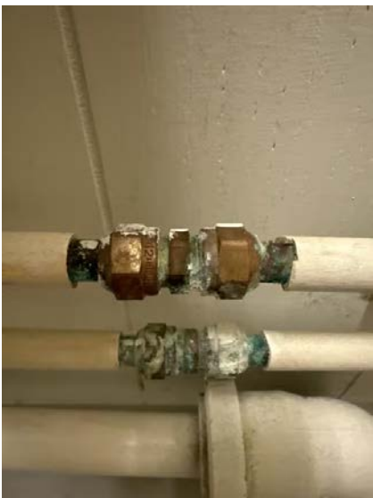
Det registreres irr/rust på kraner og koblinger.
