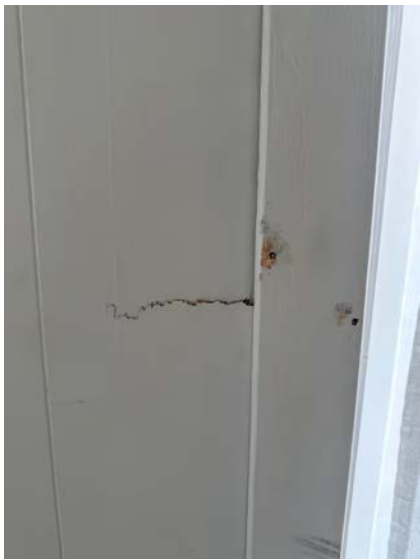
Det registreres sprekker i trepanel.
