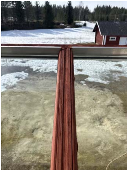
Viser tørkesprekker utvendig på vindu.
