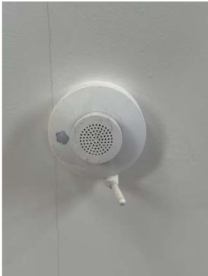
Viser brannvarsling i tak.
