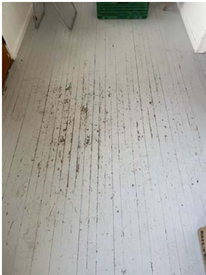
Viser eksempel på slitasje ved gulv.
