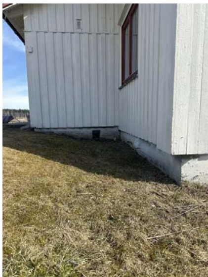
Terrenget faller inn mot bygningen og det er maksimale forhold for vann inn mot muren.
