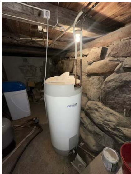
Viser bereder plassert i kjeller.
