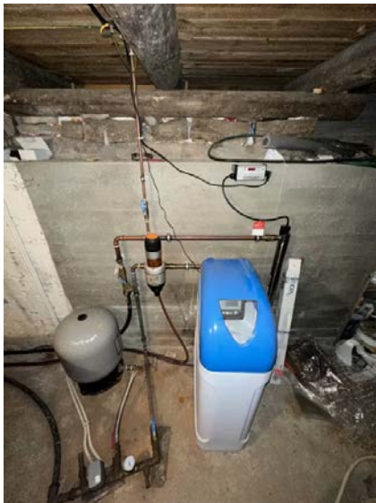
Viser stoppekran, trykktank og renseanlegg i teknisk. Funksjon og tilstand må vurderes av fagmann.
