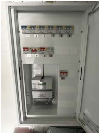
Sikringskapp plassert i trapperom i 2. etasje
