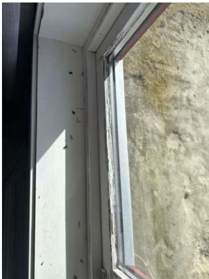
Viser avflassing på vindu antatt etter kondens.
