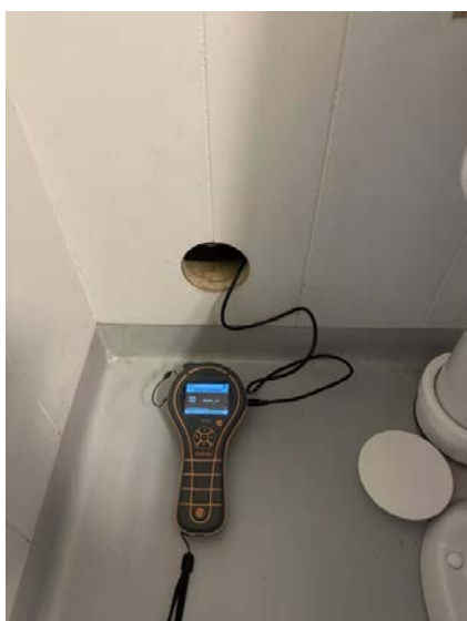
Hulltaking foretatt på toalettrom mot dusjsone.
