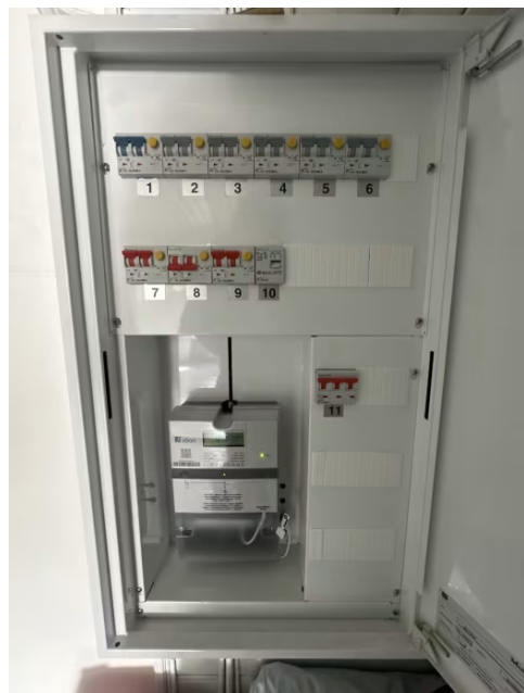
Sikringsskap plassert i trapperom i 2. etasje
