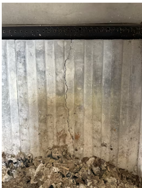
Viser sprekk i innvendig ovn i stue.
