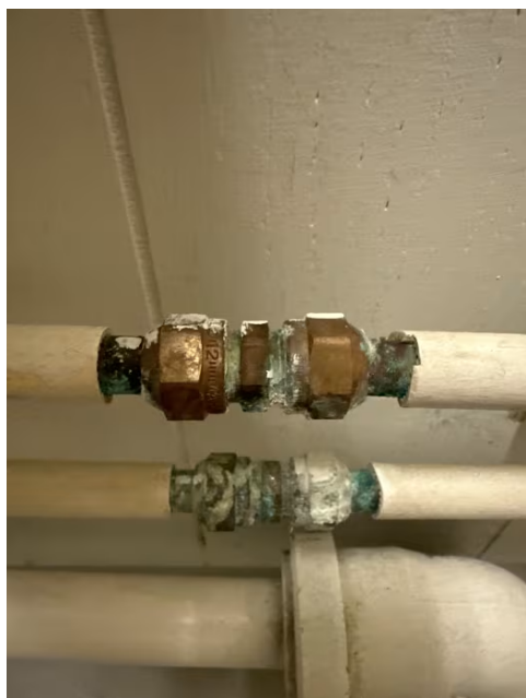
Det registreres irr/rust på kraner og koblinger.
