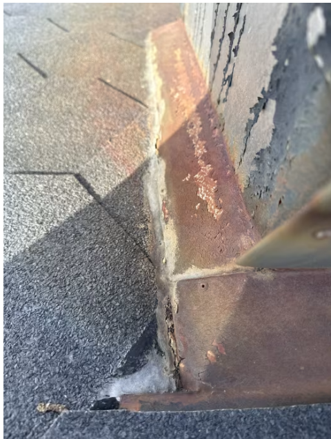
Viser rust på beslag.
