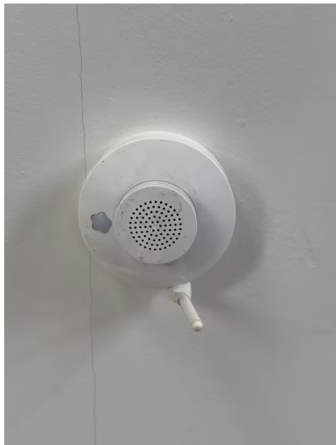
Viser brannvarsling i tak.
