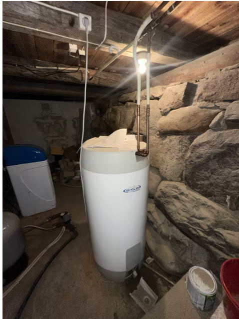
Viser bereder plassert i kjeller.
