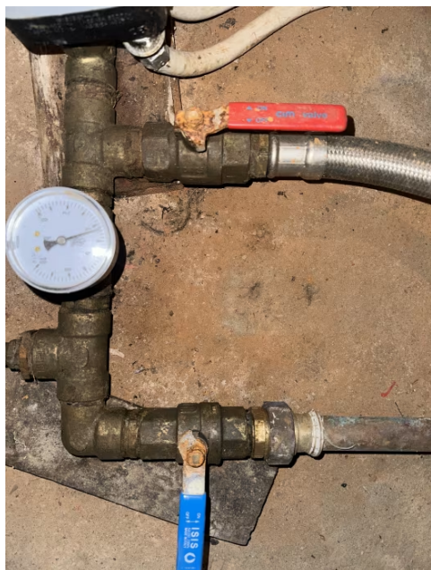
Viser irr og rust på kraner.
