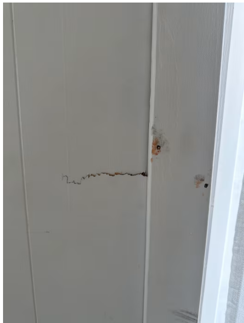
Det registreres sprekker i trepanel.
