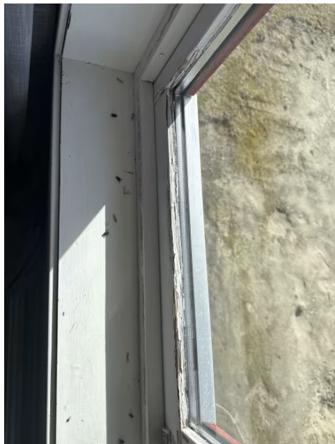
Viser avflassing på vindu antatt etter kondens.
