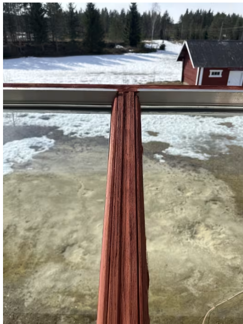
Viser tørkesprekker utvendig på vindu.
