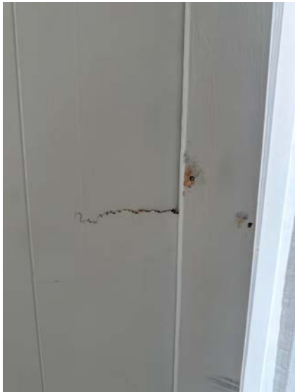
Det registreres sprekker i trepanel.
