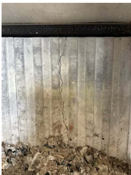
Viser sprekk i innvendig ovn i stue.
