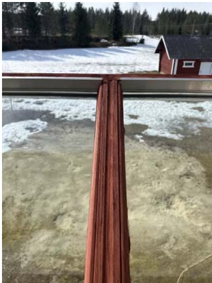
Viser tørkesprekker utvendig på vindu.
