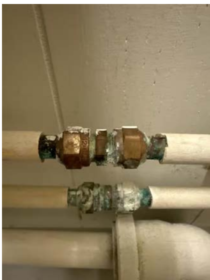
Det registreres irr/rust på kraner og koblinger.
