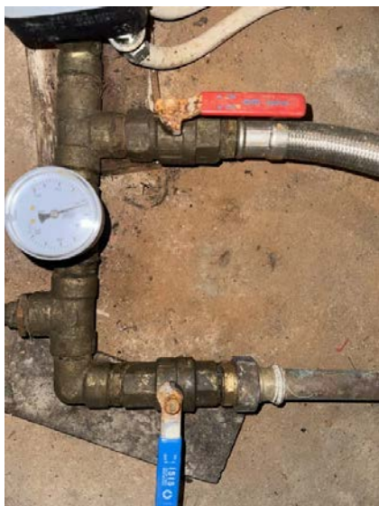
Viser irr og rust på kraner.
