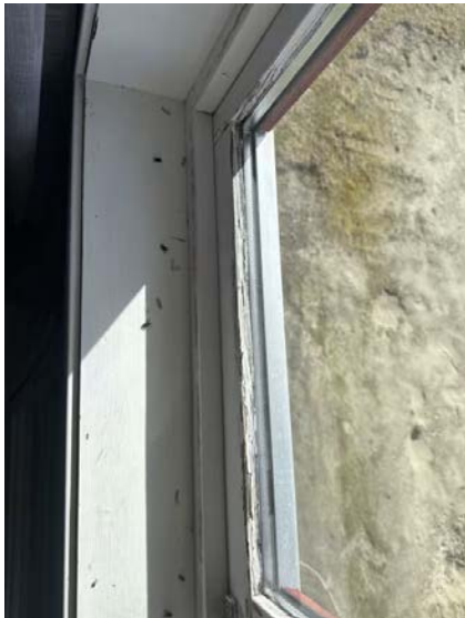
Viser avflassing på vindu antatt etter kondens.
