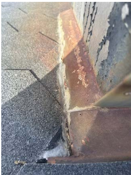
Viser rust på beslag.
