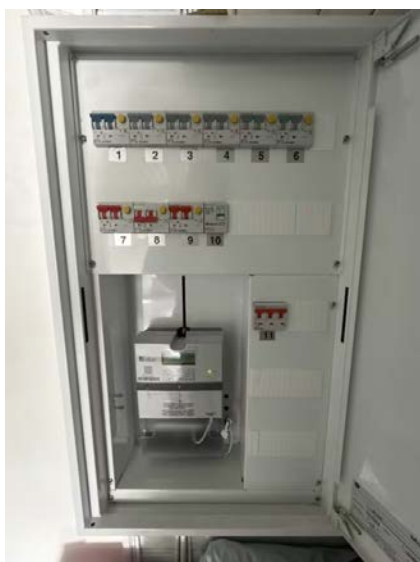
Sikringsskap plassert i trapperom i 2. etasje
