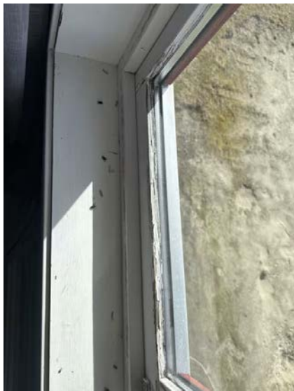
Viser avflassing på vindu antatt etter kondens.
