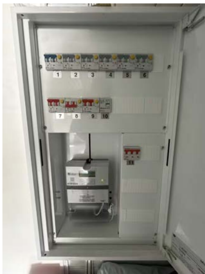
Sikringsskap plassert i trapperom i 2. etasje
