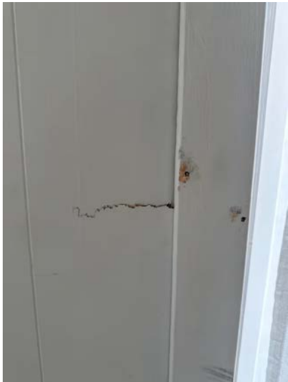
Det registreres sprekker i trepanel.
