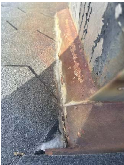
Viser rust på beslag.
