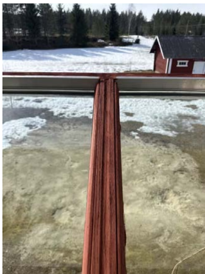
Viser tørkesprekker utvendig på vindu.
