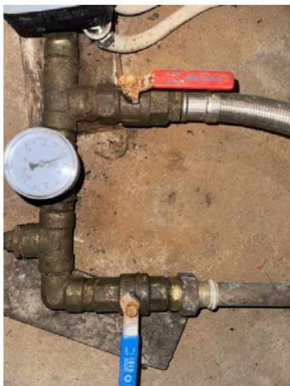
Viser irr og rust på kraner.
