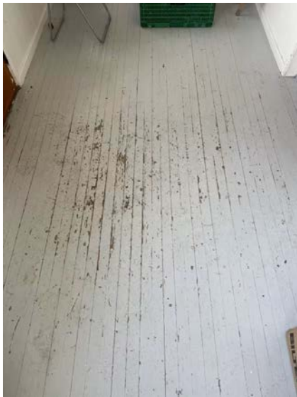
Viser eksempel på slitasje ved gulv.
