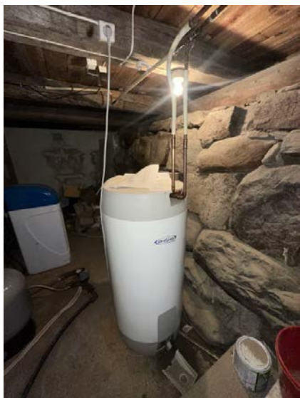
Viser bereder plassert i kjeller.
