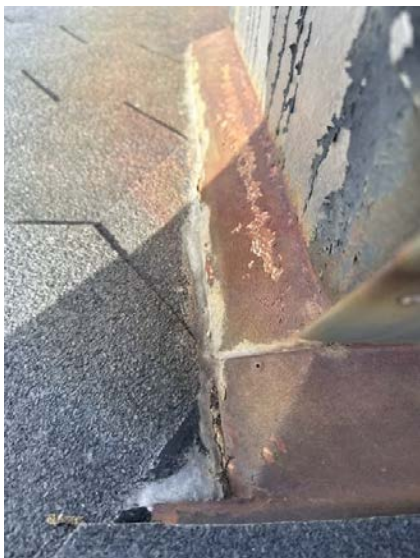
Viser rust på beslag.
