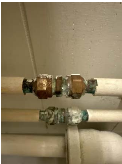
Det registreres irr/rust på kraner og koblinger.
