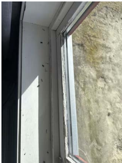
Viser avlassing på vindu antatt etter kondens.
