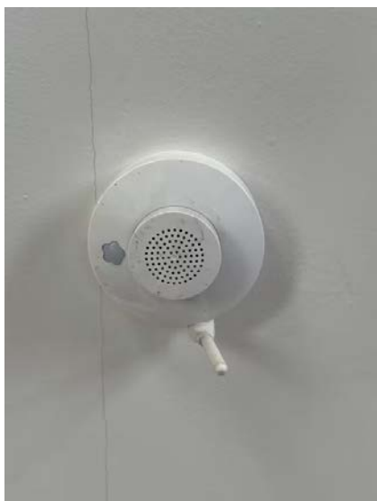
Viser brannvarsling i tak.
