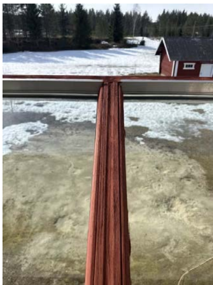
Viser tørkesprekker utvendig på vindu.
