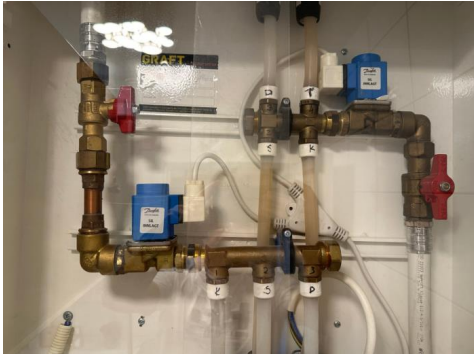
Rørskap på bad med 2 x stoppekraner
