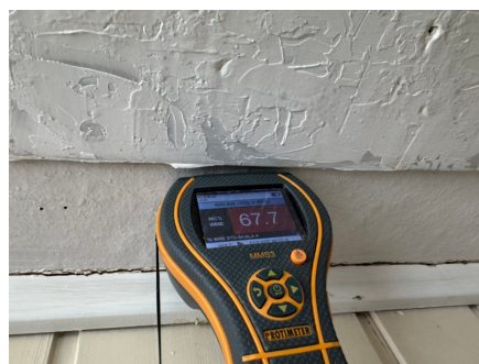
Fuktsøk i taket rundt pipen.
