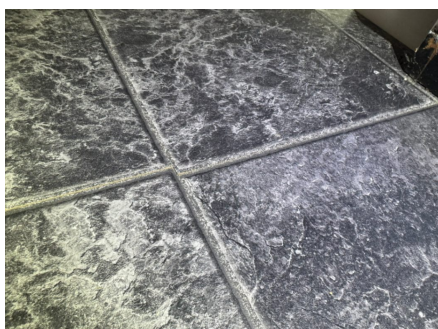
Fuktsvelling i gulvet.
