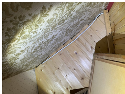
Eksempel på løse ledninger.
