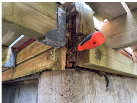
Eksempel på råteskadet kledning.
