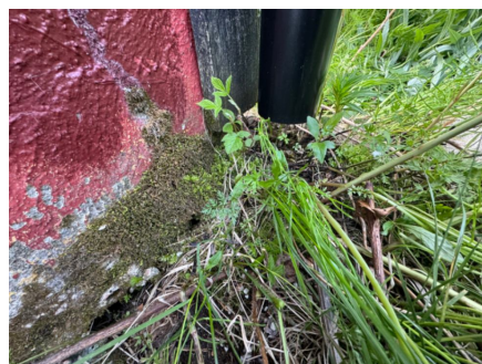
Nedløp er avsluttet over terrenget.
