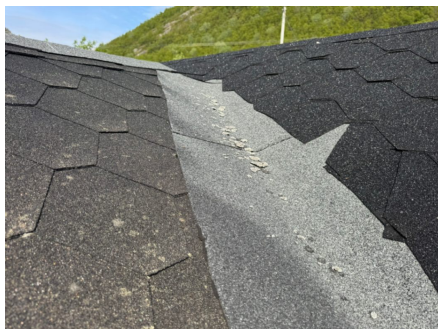
Taktekkingen er ikke lagt etter monteringsanvisningen.
