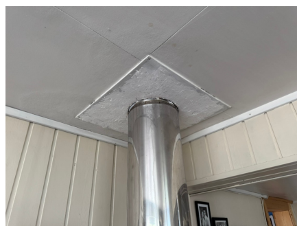
Fuktsvellinger på takplater rundt pipen.
