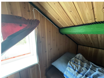
Eksempel på løse ledninger.
