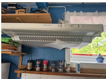
Funksjonstest av ventilatoren.
