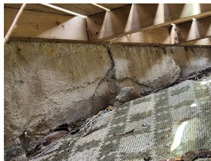
Eksempel på sprekk i grunnmuren.
