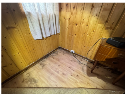
Fuktmerker på innvendige overflater på soverommet.
