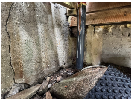
Eksempel på sprekk i grunnmuren.
