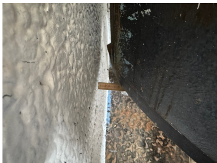
Ildstedet står for nært brannmuren.
