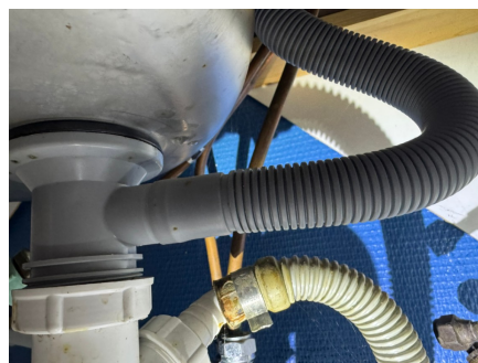
Lekkasje fra pakning.
