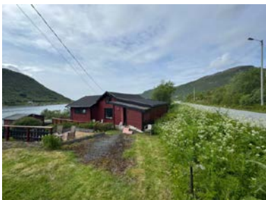
Terrenget har fall mot boligen.
