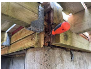
Eksempel på råteskadet kledning.
