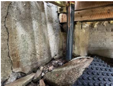
Eksempel på sprekk i grunnmuren.
