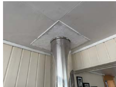
Fuktsvellinger på takplater rundt pipen.
