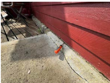
Uheldig overgang fra grunnmuren til veggkonstruksjonen.
