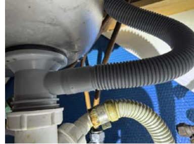
Lekkasje fra pakning.
