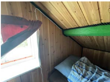
Eksempel på løse ledninger.
