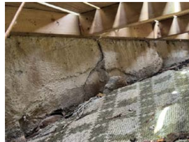
Eksempel på sprekk i grunnmuren.
