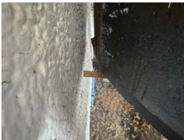
Ildstedet står for nært brannmuren.
