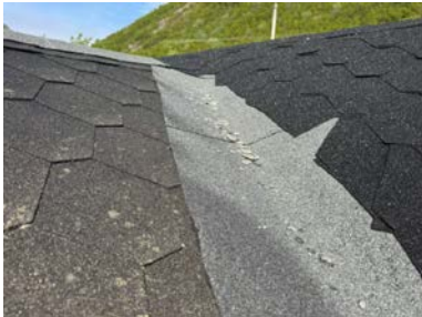
Taktekkingen er ikke lagt etter monteringsanvisningen.
