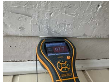
Fuktsøk i taket rundt pipen.
