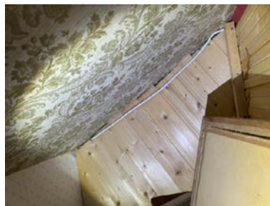
Eksempel på løse ledninger.
