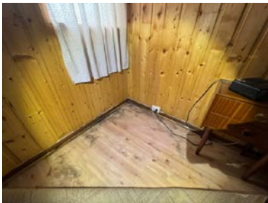
Fuktmerker på innvendige overflater på soverommet.
