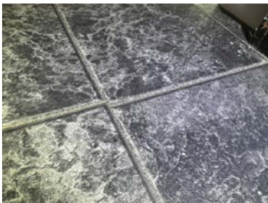
Fuktsvelling i gulvet.
