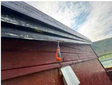
Eksempel på råteskadet kledning.
