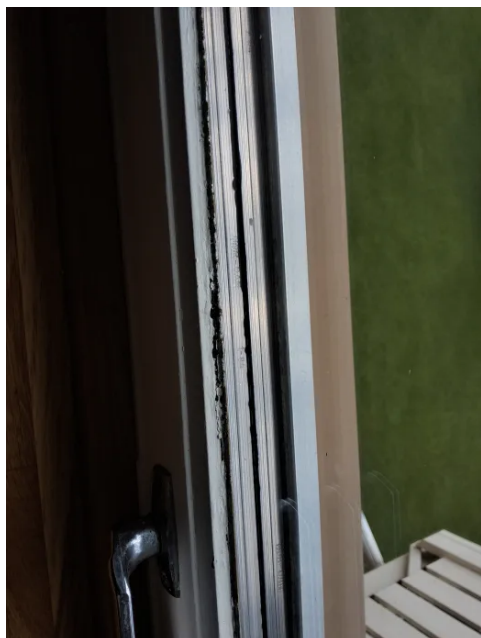
Spor etter kondens (krakelert maling) registreres på innsiden av vinduer
