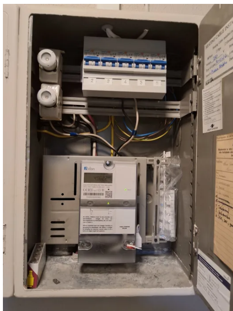
Sikringsskap er plassert i felles trappeoppgang.
