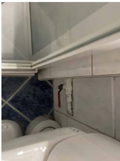
Hovedstoppekran er plassert på bad.
