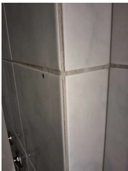
Det registreres riss i flisfuger til veggfliser.
