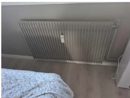
Leiligheten er oppvarmet med radiatorer tilknyttet fjernvarme.
