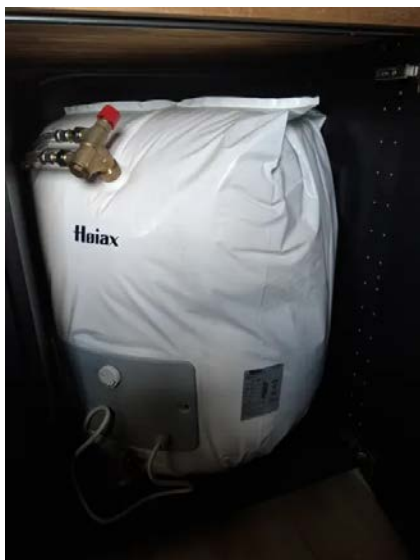
Varmtvannsbereder er plassert i kjøkkenskap.
