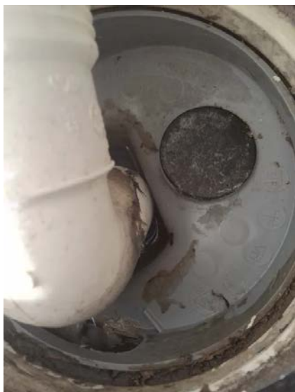
Det kan ikke verifiseres at utførelsen av overgang membran/sluk er korrekt.
