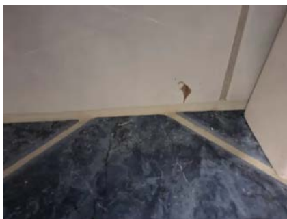
Det registreres hakk/skader i veggflis.
