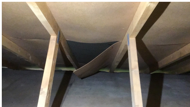
Undertak som er bøyd ned
