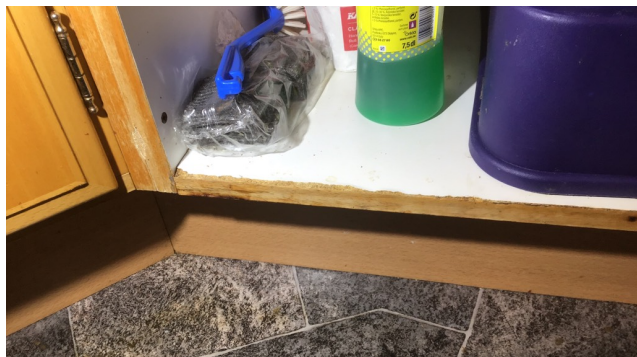
skader i bunn skap under vask
