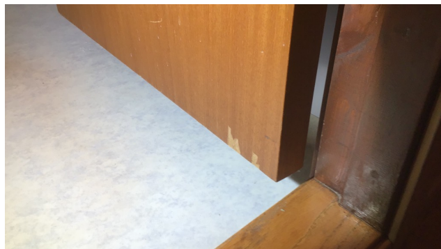
Skade i nedkant
