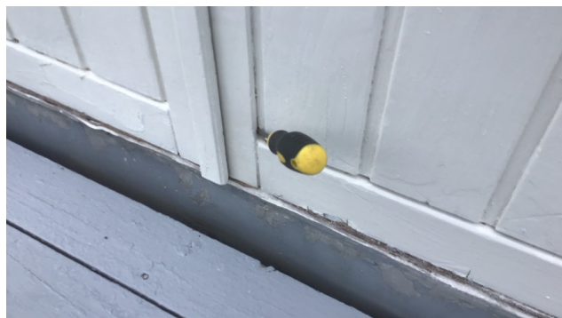
Fukt i nedkant i balkongdør i stue
