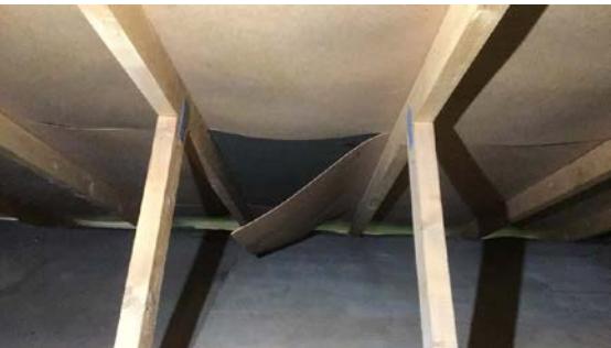
Undertak som er bøyd ned
