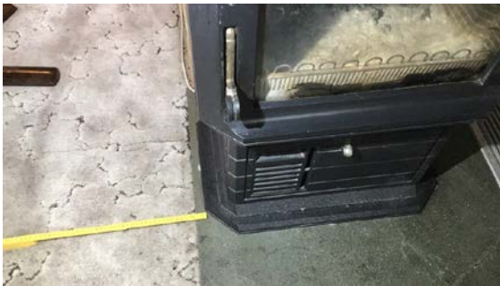
Mangler ildfast plate på siden av ovnen i stue
