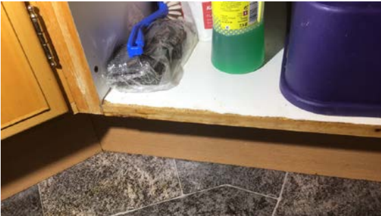
skader i bunn skap under vask
