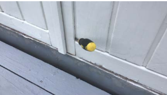
Fukt i nedkant i balkongdør i stue
