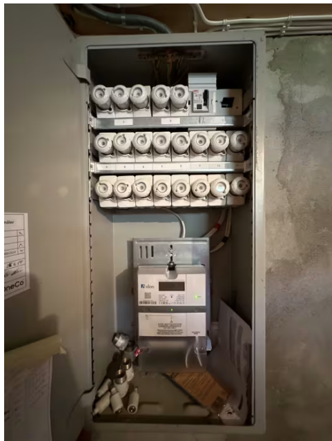
Viser sikringsskap plassert i kjeller.
