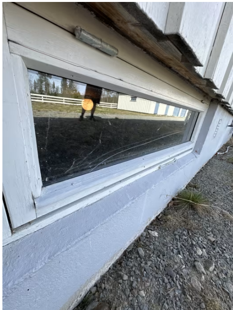
Viser sprekk i glass.
