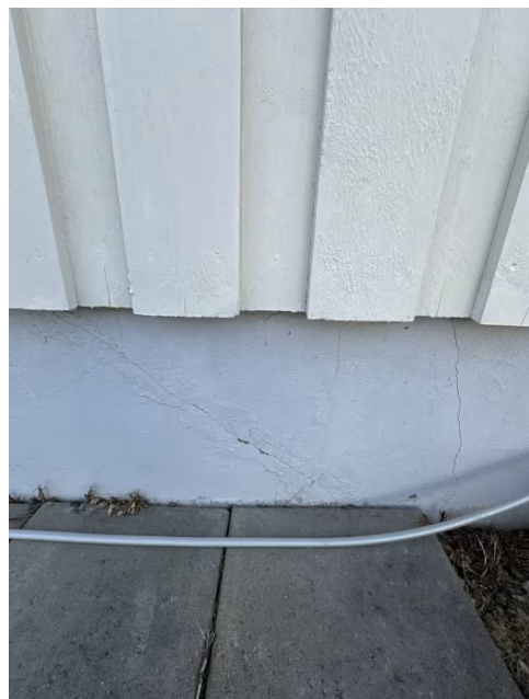
Viser sprekker i grunnmur.
