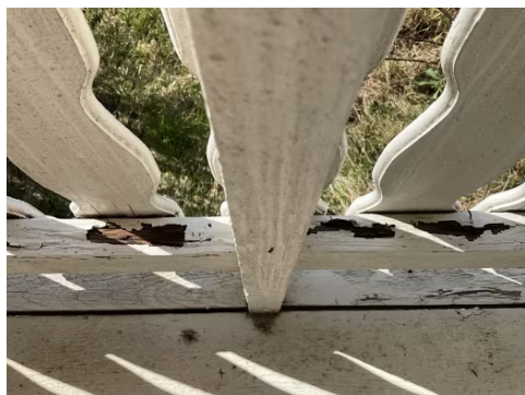
Viser råteskader i rekkverket.
