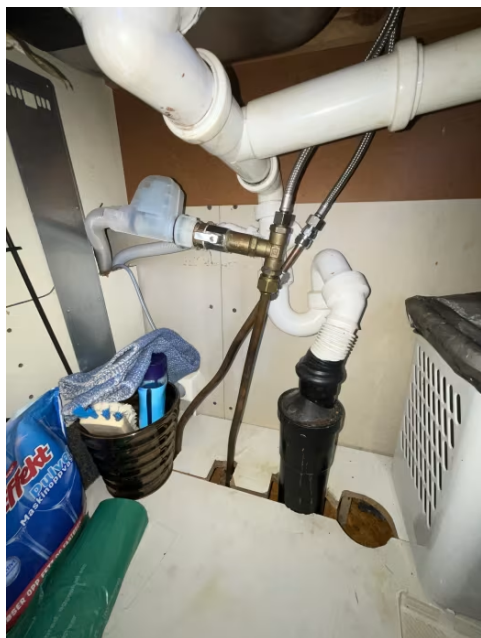
Viser vann og avløpsinnstallasjoner under kum.
