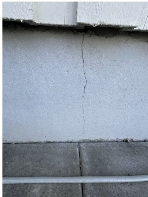
Viser sprekk i grunnmur.
