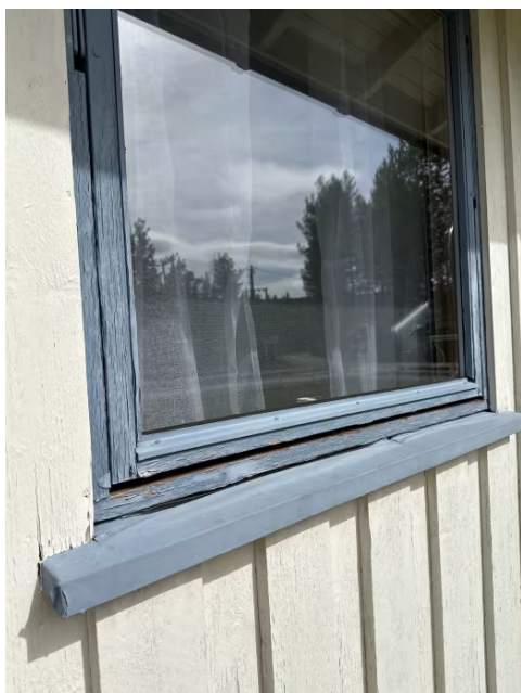
Viser slitasje på vindu og beslag.
