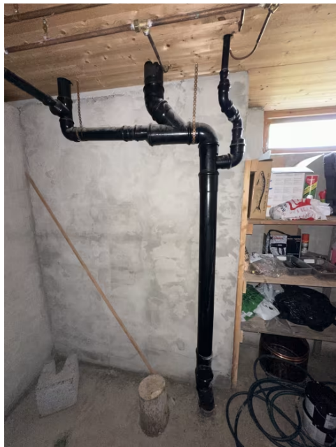
Viser avløpsrør i kjeller.
