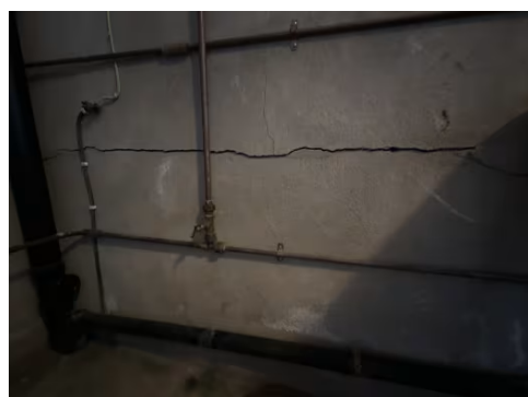
Viser sprekk i grunnmur i kjellerrom.
