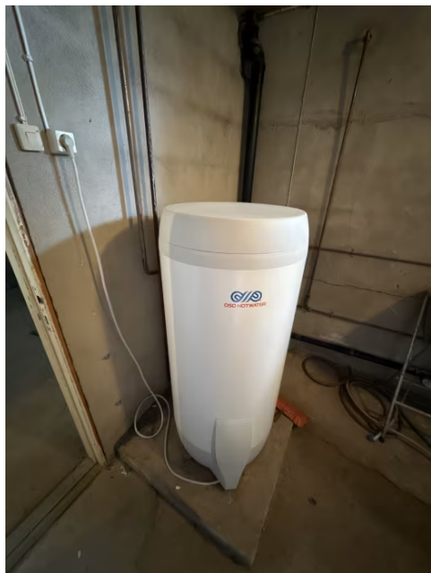
Viser bereder plassert i kjeller.
