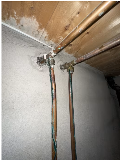
Viser irr på rør og koblinger.
