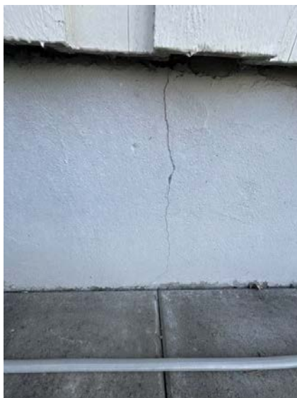
Viser sprekk i grunnmur.
