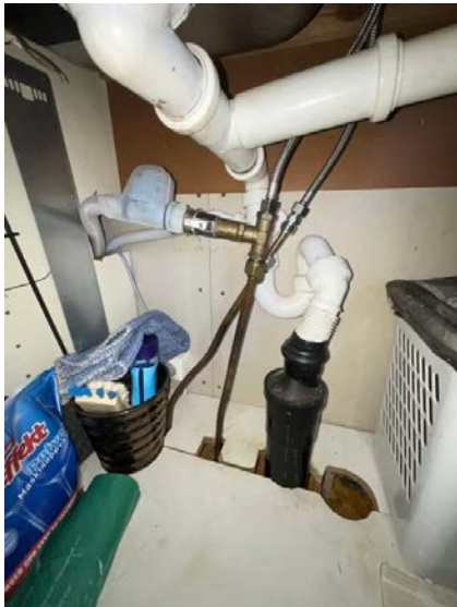
Viser vann og avløpsinnstallasjoner under kum.
