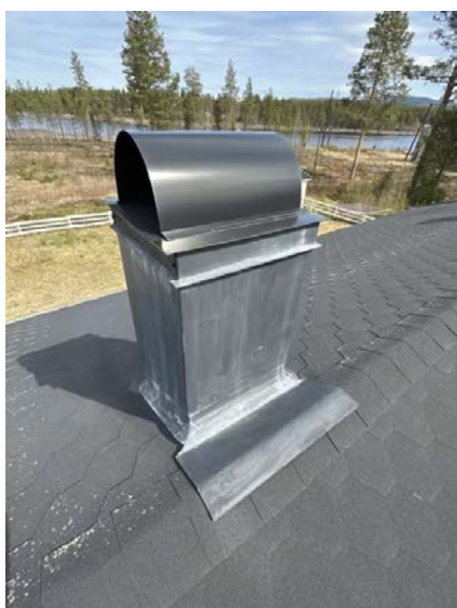
Viser helseslått pipe over tak med regnskjerm.
