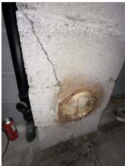
Det registreres sprekk i pipe og rust på sotluke i kjeller. Sotluke må tømmes.
