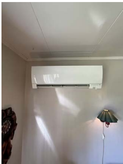
Viser innedel montert i stue.
