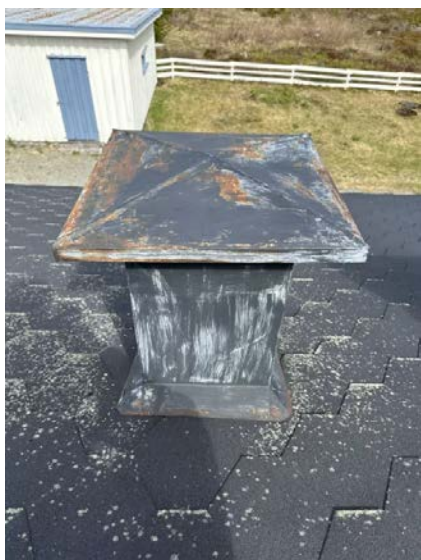
Det er observert rustdannelse på beslag.
