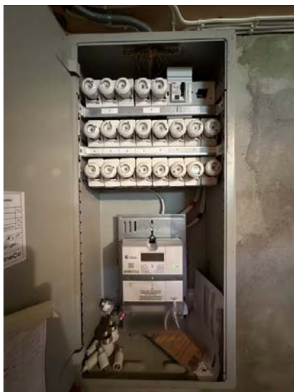
Viser sikringsskap plassert i kjeller.
