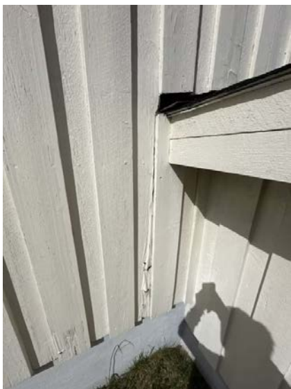
Det er påvist avvik ved beslagsløsninger på takoverbygg til kjellernedgang.
