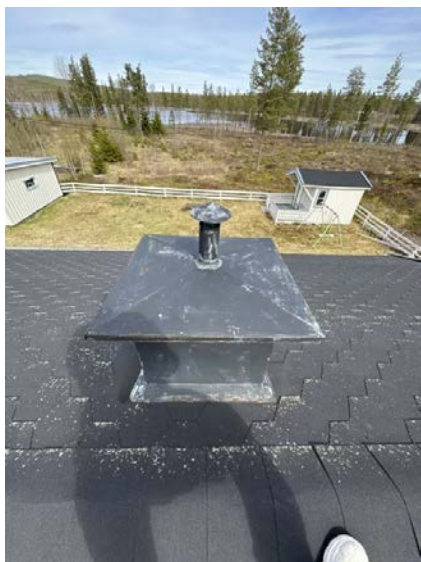
Det er observert rustdannelse på beslag.
