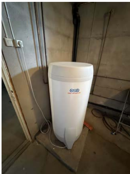
Viser bereder plassert i kjeller.
