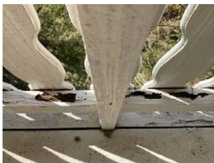
Viser råteskader i rekkverket.
