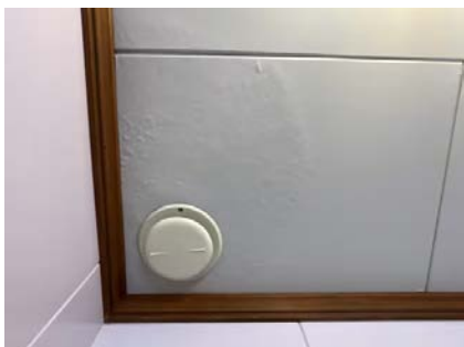
Fuktmerker rundt ventil i himling.
