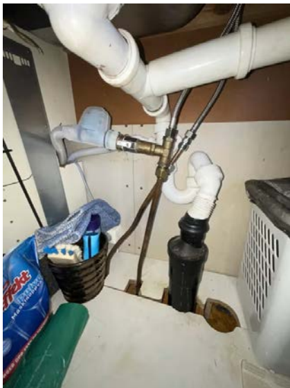
Viser vann og avløpsinnstallasjoner under kum.
