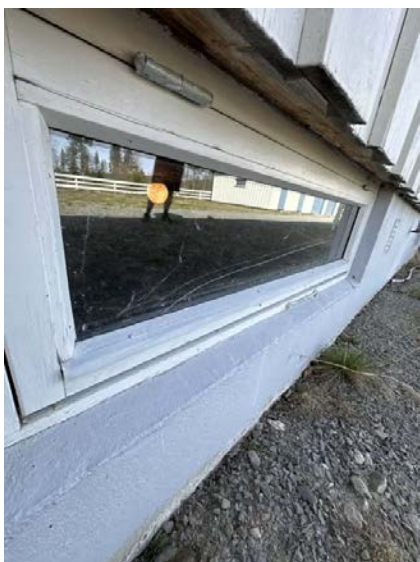
Viser sprekk i glass.
