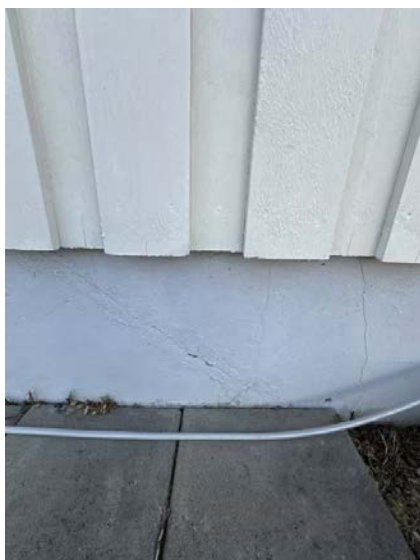
Viser sprekker i grunnmur.
