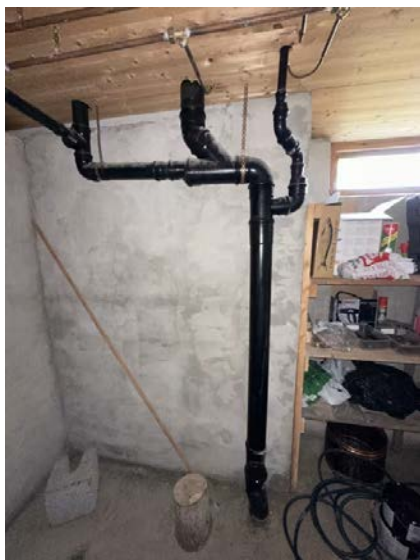
Viser avløpsrør i kjeller.
