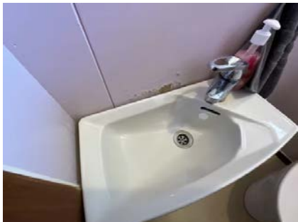
Det er fuktskader pga vannsøl på plate ved servant.
