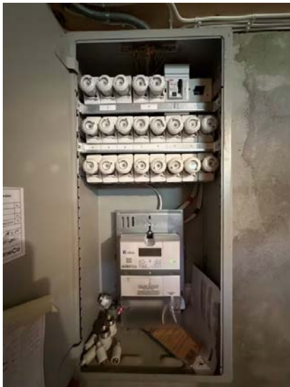
Viser sikringsskap plassert i kjeller.
