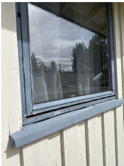
Viser slitasje på vindu og beslag.
