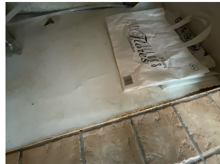
Fuktskade i bunnplate i kjøkkenbenk.
