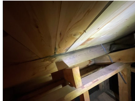
Tegn til misfarging i konstruksjon i kneloft
