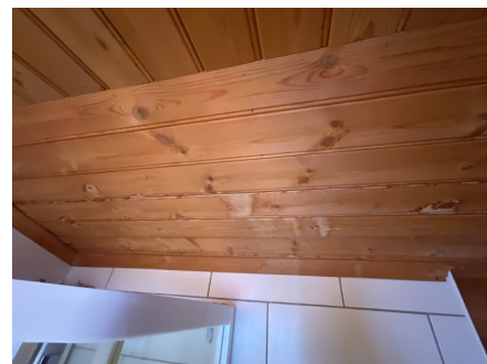
Fuktskjolder i tak på bad.
