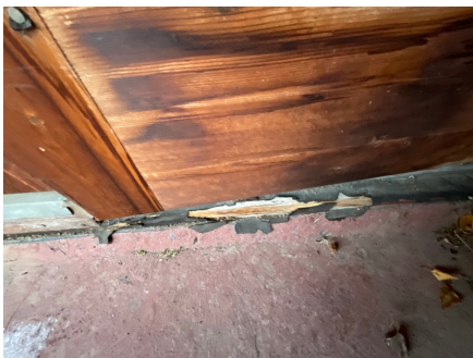
Skader i tetting under tearredøren
