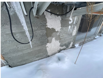
Utvendig slitasje grunnmur
