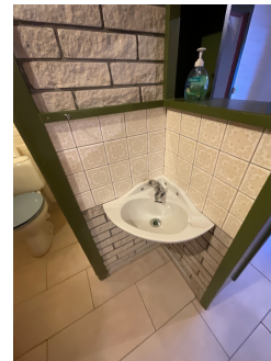
Servant for toalettrom er plassert i tilstøtende gang.
