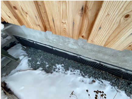
Grunnmursplast har løsnet fra klemlist ved tilbygg
