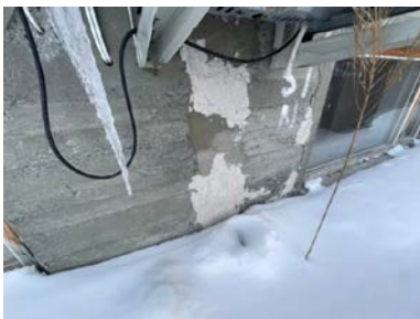
Utvendig slitasje grunnmur
