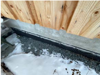
Grunnmursplast har løsnet fra klemlist ved tilbygg
