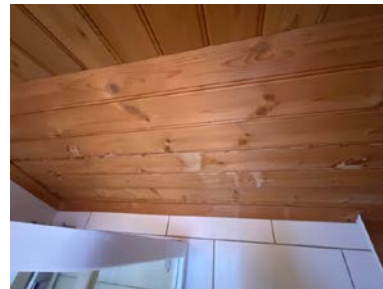
Fuktskjolder i tak på bad.
