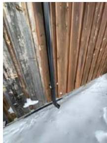
Takvann er ikke ledet bort fra grunnmur
