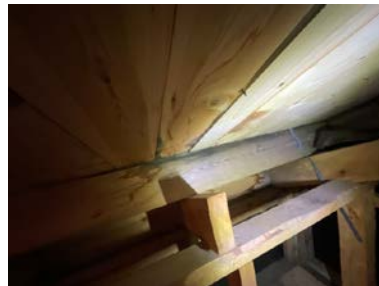
Tegn til misfarging i konstruksjon i kneloft
