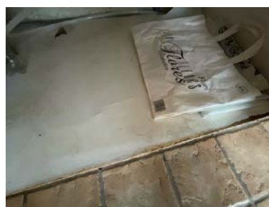
Fuktskade i bunnplate i kjøkkenbenk.
