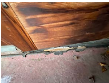
Skader i tetting under tearredøren
