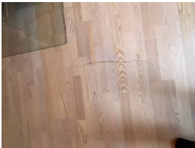
Skader i gulv i stue i 1. etasje
