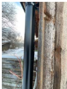
Frotspreng i enkelte taknedløp
