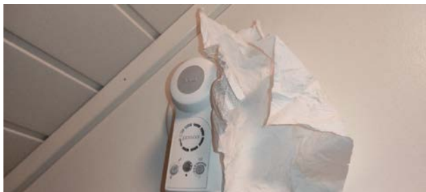
Funksjonstest av avtrekk.
