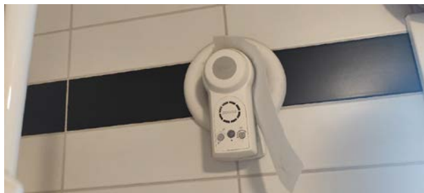
Funksjonstest av avtrekk.
