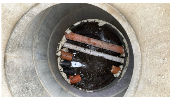
Rør kommer inn på tomten via kum i hagen
