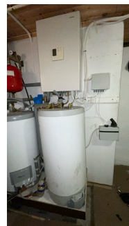
Varmtvannstank fungerer som buffertank for gulvvarme som er tilkoblet. Buffertank er fra 2010 med fast tilkobling.
