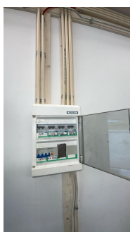
Sikringsskap i garasje med merking
