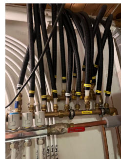
Vannrør er merket etter befaringen av selger. Bilde er tilsendt
