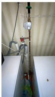
Hovedstoppekrane med vannstoppventil
