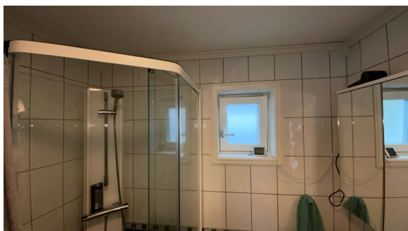
Vindu er plassert i våtsone ved dusjkabinett
