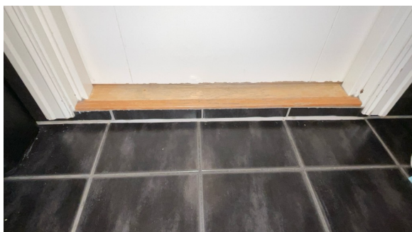
Tilluftsspalte under dør
