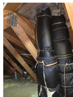
Mangler mansjett ved gjennomføringer i undertak fra byggeår
