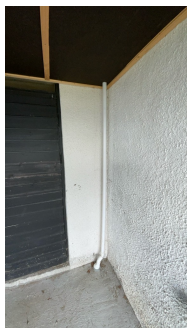
Avløp fra vaskekum i garasje/verksted er ført til rør for takvann.
