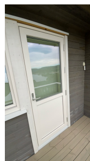
Verandadør ved soverom fra 2020 med 3-lags glass
