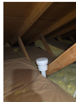
Durgo/avløpsventil er tilgjengelig på kryploftet
