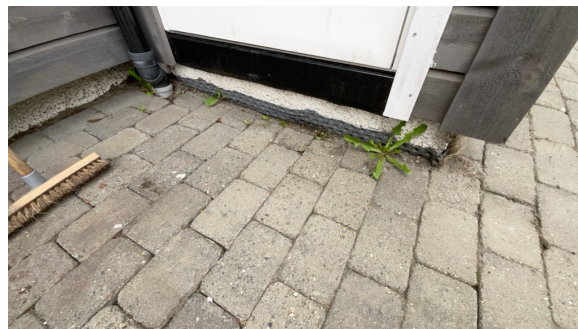
Mangler kantlist på grunnmursplast
