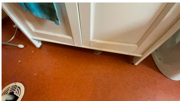
Skader på front til innredningen
