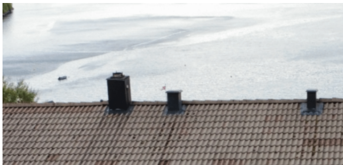
Pipe mangler pipehatt og takstige
