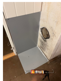
Montert brannsikrer plate på vegg og på gulv ved sotluke er utført av selger etter beferingen. Bilde er tilsendt av selger
