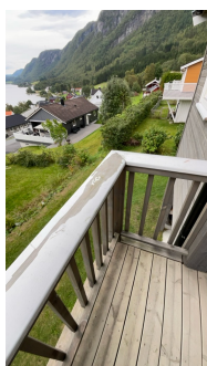
Avskalling av maling på håndrekke
