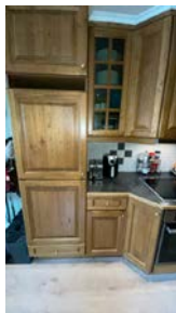
Mangler rist/deksel over dør hvor det tidligere har vært integrert kjøleskap. Oversikt
