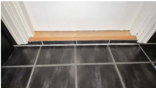
Tilluftsspalte under dør
