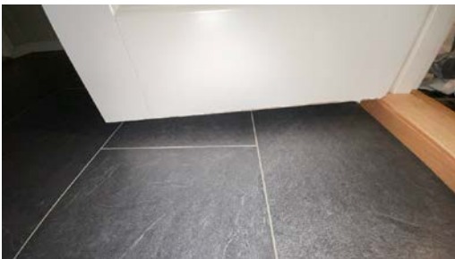
Skade på nedre del av dør
