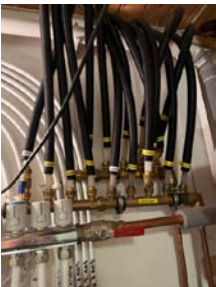
Vannrør er merket etter befaringen av selger. Bilde er tilsendt
