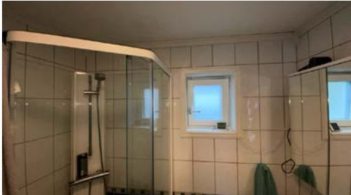
Vindu er plassert i våtsone ved dusjkabinett
