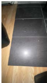
Noe løs flis og manglende fugemasse under vedovn i underetasjen
