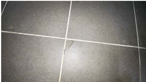
Skade i ei flis
