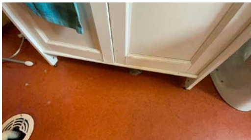
Skader på front til innredningen
