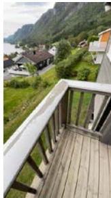
Avskalling av maling på håndreke
