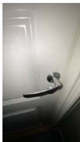
Noe overflateslitasje på dør til soverom 2
