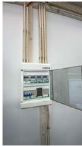
Sikringsskap i garasje med merking
