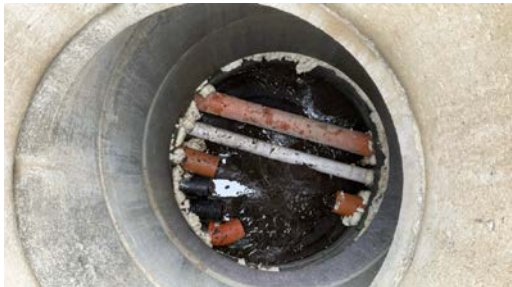
Rør kommer inn på tomten via kum i hagen
