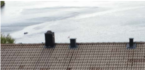
Pipe mangler pipehatt og takstige
