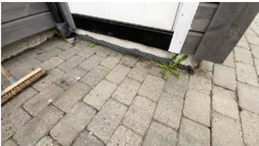
Mangler kantlist på grunnmursplast
