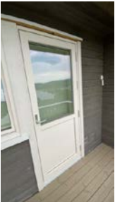
Verandadør ved soverom fra 2020 med 3-lags glass
