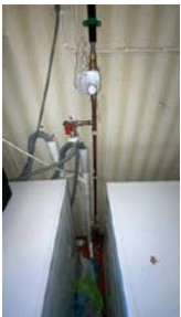
Hovedstoppekrane med vannstoppventil
