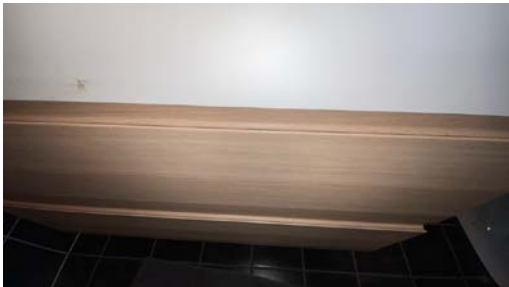
Noe mindre hakk/skader på folie til skuffer under vasken
