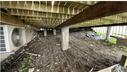
Oversikt under veranda som viser at veranda er opplagret på eldre søyler, dragere og vinkler mot vegg. Det er noe nedbøyning på veggvinkler, selger bekrefter at det har vært uendret siden byggeår
