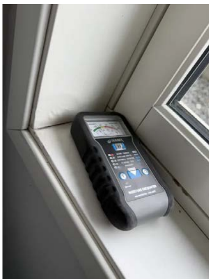
Fuktskader vindusforing kjeller vindu soverom, det ble ikke registrert fukt i berørt område på befaringsdagen.
