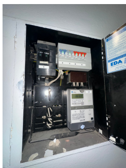
Sikringsskap med automatsikringer.
