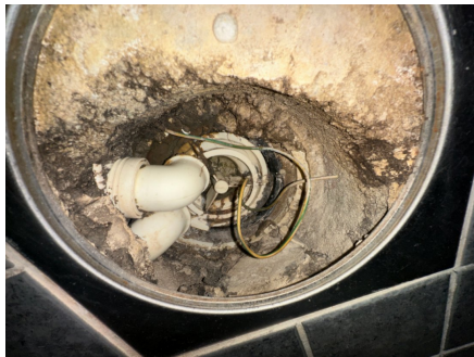
Sluk i plast, plassert i dusjnisje
