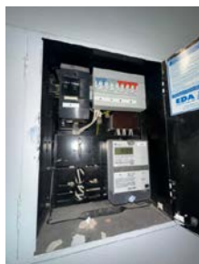
Sikringsskap med automatsikringer.
