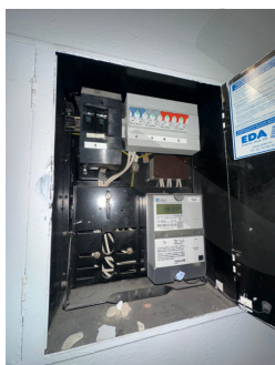
Sikringsskap med automatsikringer.
