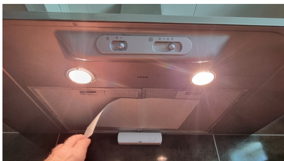
Funksjonstesting av det mekaniske avtrekket over koketoppen.
