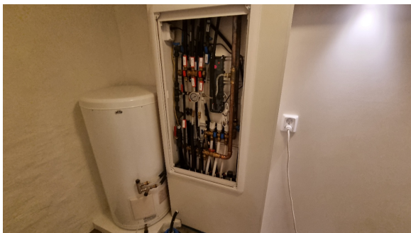
Kontroll av fordelerskap.
