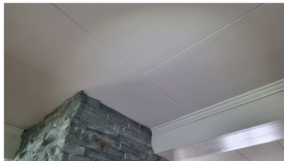
Fuktsvell i himling ved pipen.
