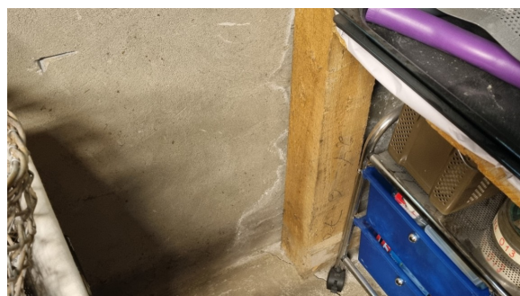
Saltutslag i bod i kjeller.
