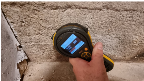
Fuktmåling av kjelleryttervegg i fyrrom. Noe forhøyede fuktverdier ble registrert.
