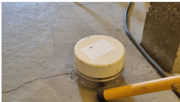
Radonbrønn i tilbygget del.
