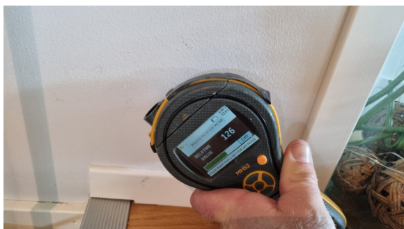
Fuktmåling foretatt i vegg fra tilstøtende rom, her vist fra tv-stue/spisestue.
