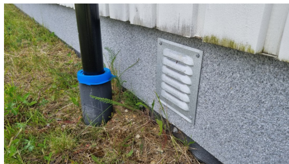
Ytterkledning er moden for overflatebehandling.
