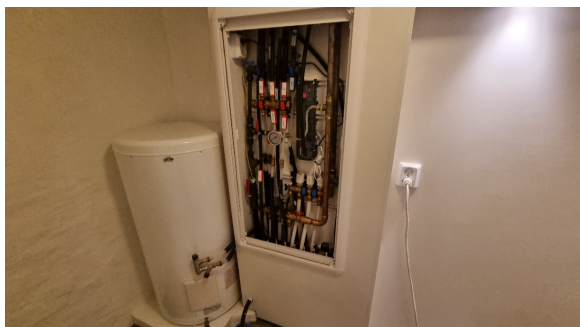
Fordelerstokker er plassert i skap i teknisk rom.
