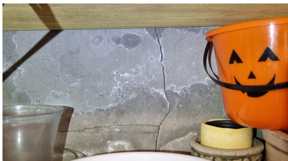
Sprekker i grunnmur/yttervegg i bod i kjeller.
