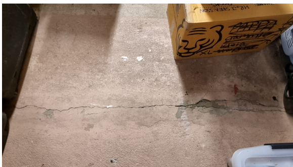
Stedvis riss/sprekker i betonggulvet i opprinnelige del.
