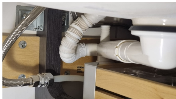
Kontroll av rørøpplagg under servanten.
