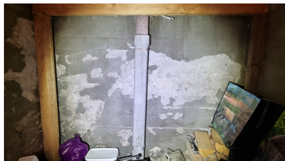
Avskalling i grunnmur/yttervegger i fyrrommet.
