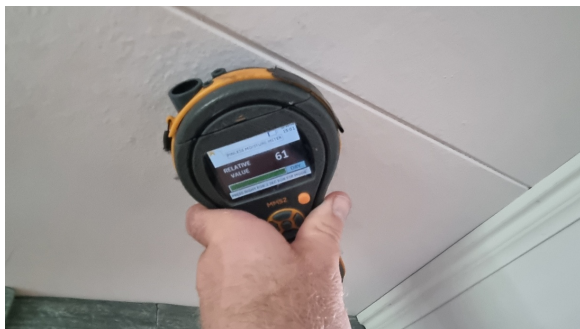
Fuktmåling i himling
