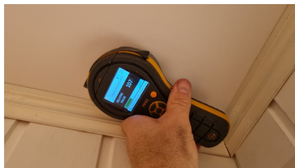
Fuktmåling foretatt i himling i kjelleretasjen under baderommet.
