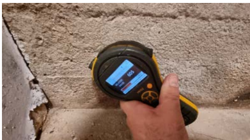
Fuktmåling av kjelleryttervegg i fyrrom. Noe forhøyede fuktverdier ble registrert.
