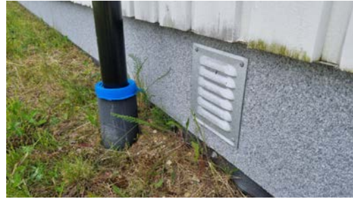
Ytterkledning er moden for overflatebehandling.
