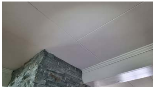
Fuktsvell i himling ved pipen.
