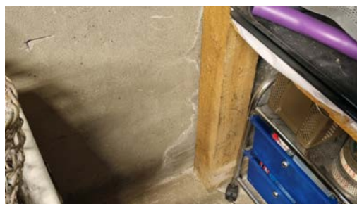
Saltutslag i bod i kjeller.
