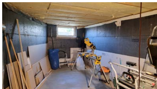
Synlig isopor i den uinnredede kjellerdelen.
