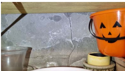
Sprekker i grunnmur/yttervegg i bod i kjeller.
