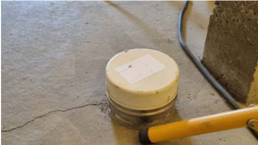
Radonbrønn i tilbygget del.
