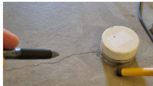
Riss/sprekk i betonggulvet i tilbygget del i kjeller.
