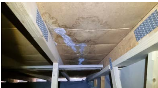
Fuktmerke og hvit soppvekst i deler av undertak. Dette skyldes trolig tidligere lekkasje her.
