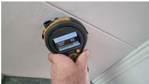
Fuktmåling i himling
