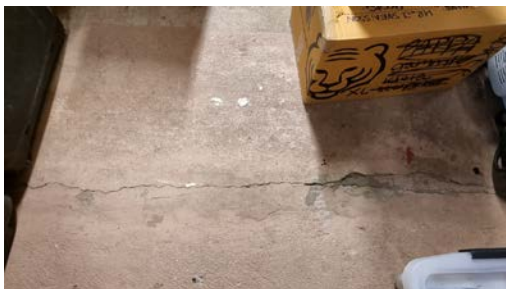
Stedvis riss/sprekker i betonggulvet i opprinnelige del.
