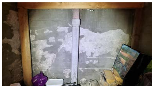
Avskalling i grunnmur/yttervegger i fyrrommet.
