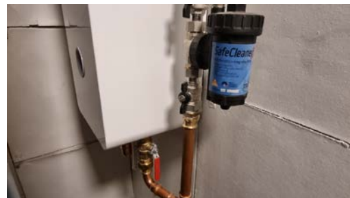
El-kassett for gulvvarmen er plassert i fyrrommet.
