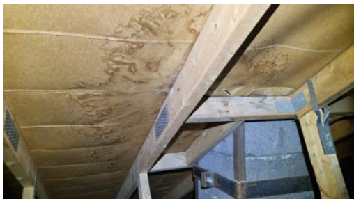
Fuktmerker og utettheter i undertaket ved pipen. Det ble fuktmålt her ved befaring, ingen unormale fuktverdier ble registrert
