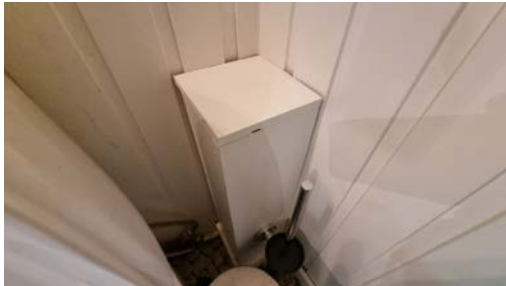
Lufting av kloakken i toalettrommet i 2. etasje.
