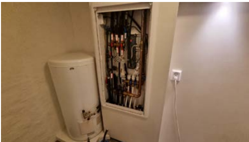
Kontroll av fordelerkap.
