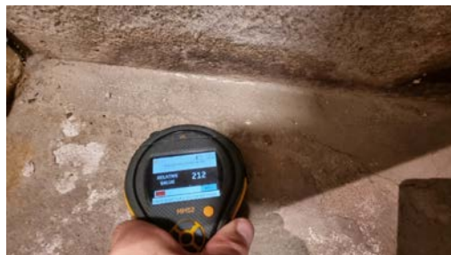
Fuktmåling i kjeller.
