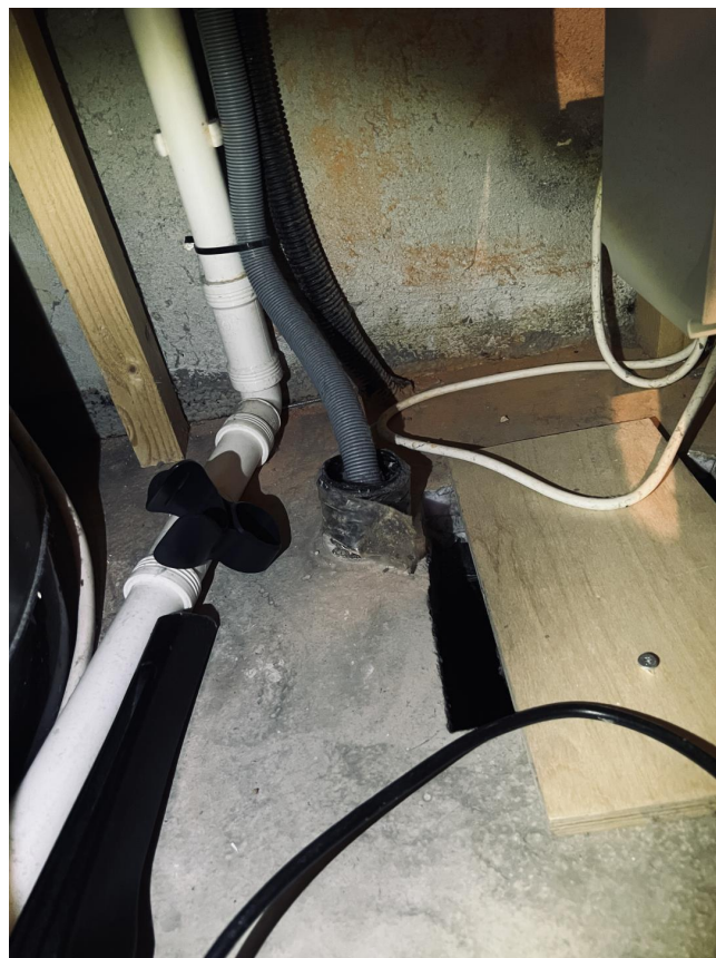
Overvannskum med pumpe, plassert i bod.
