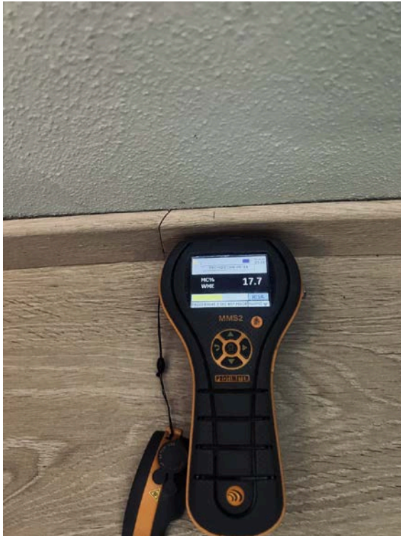
Antydning til forhøyede fuktverdier i kjeller.
