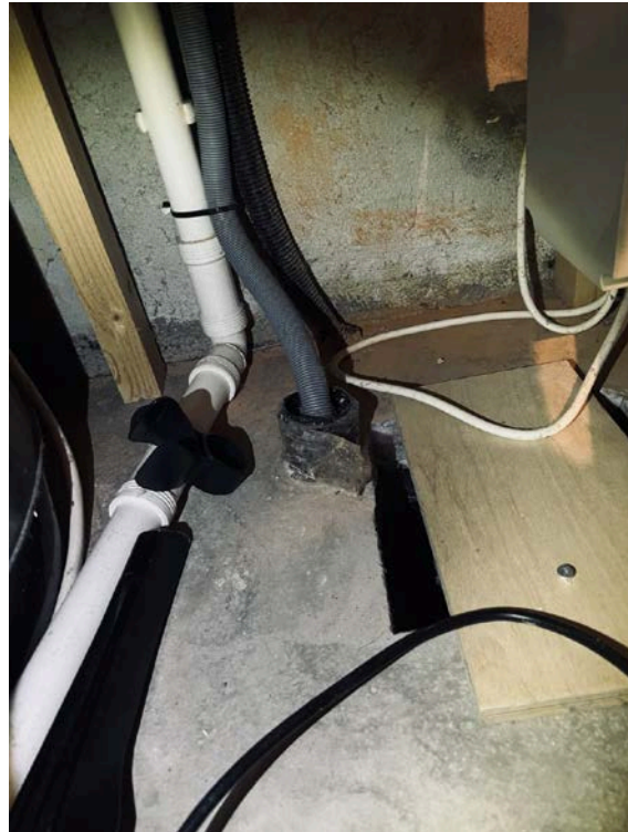
Overvannskum med pumpe, plassert i bod.
