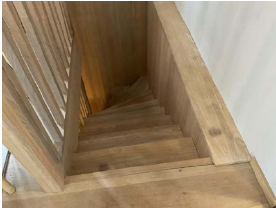
Manglende håndløper og fallsikring.
