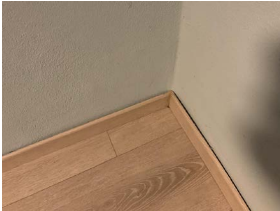
Det er noe glipper mellom vegg og lister i kjeller.
