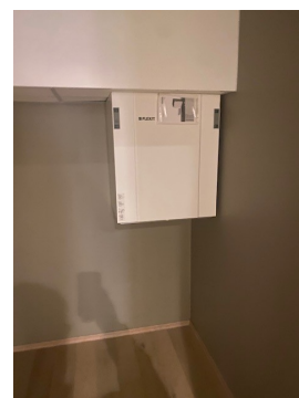
Aggregat plassert på bod i leiligheten
