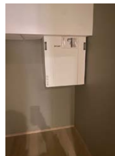
Aggregat plassert på bod i leiligheten
