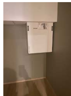
Aggregat plassert på bod i leiligheten
