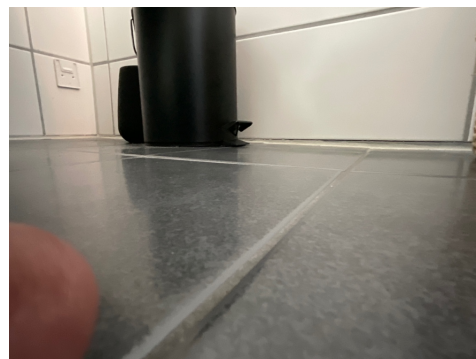
Sprekk i fugemasse/flisfuge
