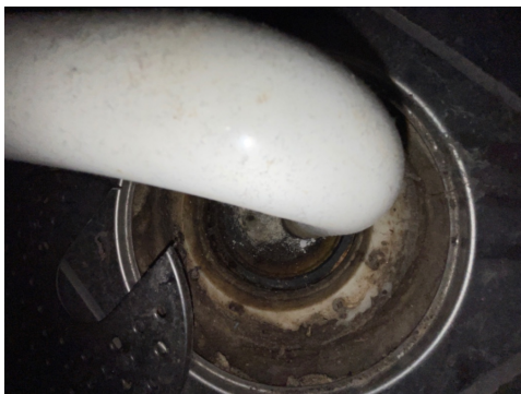
Sluk under dusjkabinett
