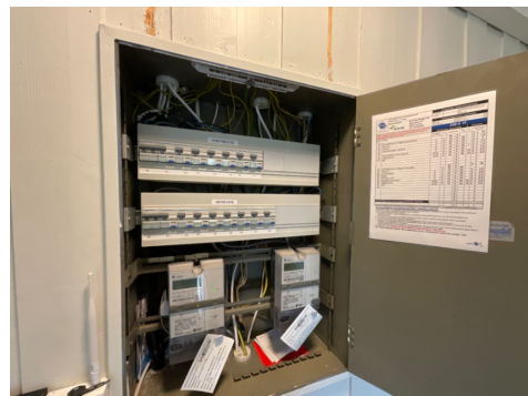
Sikringsskap i felles trappegang
