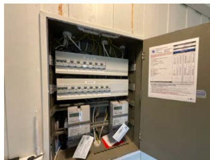
Sikringsskap i felles trappegang
