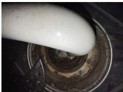
Sluk under dusjkabinett
