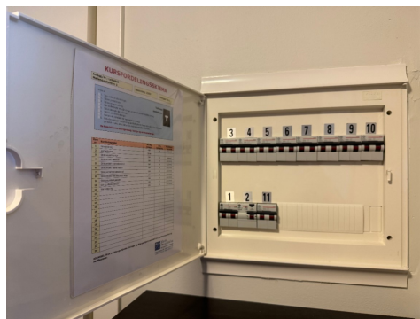
Sikringsskap i entre/gang.
