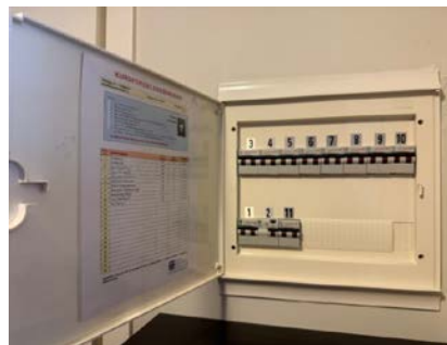
Sikringskap i entre/gang.
