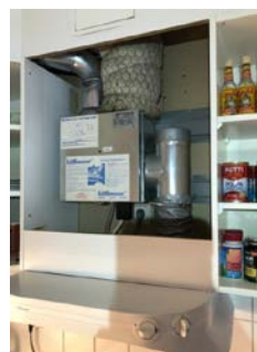
Bilde av avtrekksviften over ventilator
