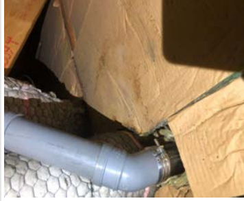
Fuktskjolder på isolasjon. Antatt fra kondens
