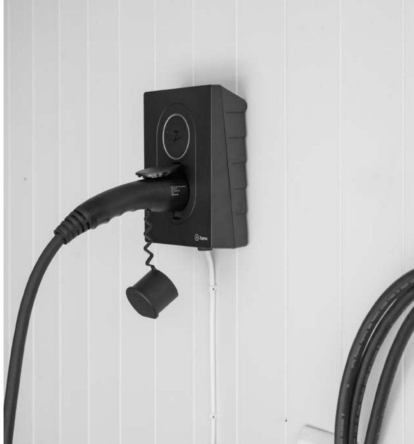
Garasjen er utstyrt med elbil-lader.
