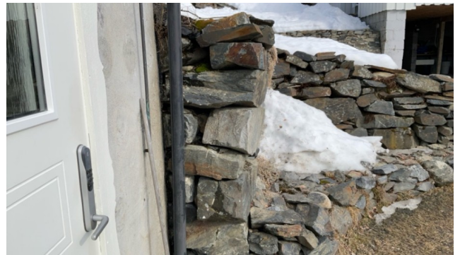
Forstøtningsmur uten rekkverk.
