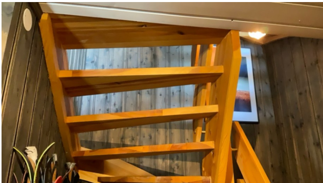
Innvendig trapp med åpninger mellom opptrinn større enn 10 cm
