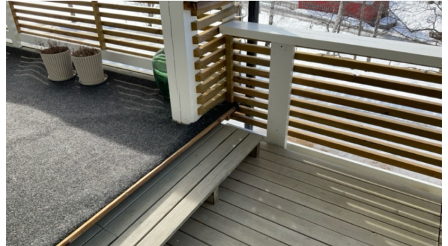
Rekkverk terrasse og balkong med lav rekkverkshøyde
