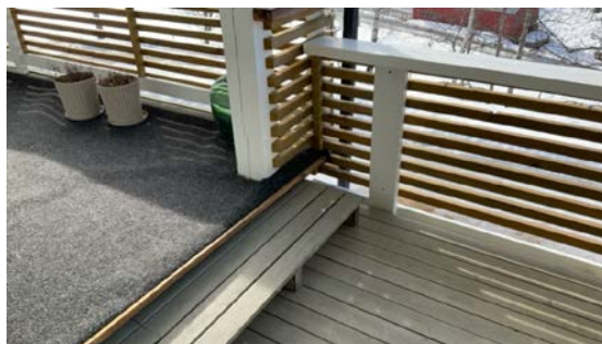
Rekkverk terrasse og balkong med lav rekkverkshøyde
