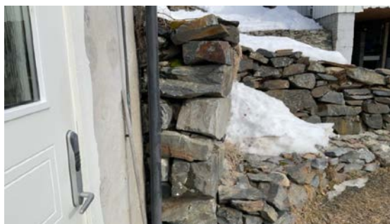
Forstøtningsmur uten rekkverk.
