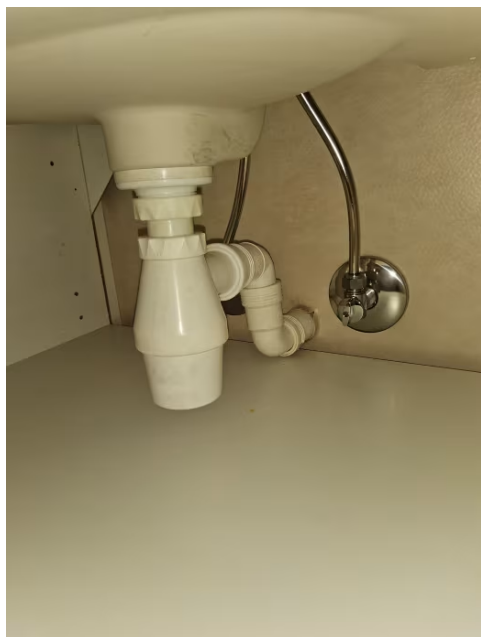
Bilde viser avløpsrør på bad.
