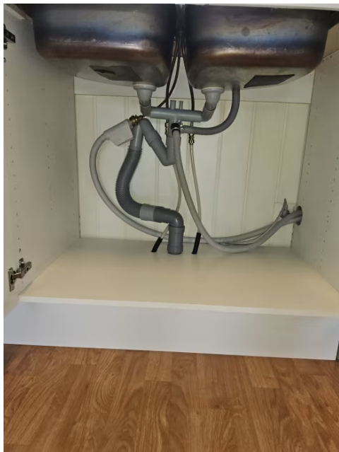
Bilde viser røropplegg under oppvaskkum.
