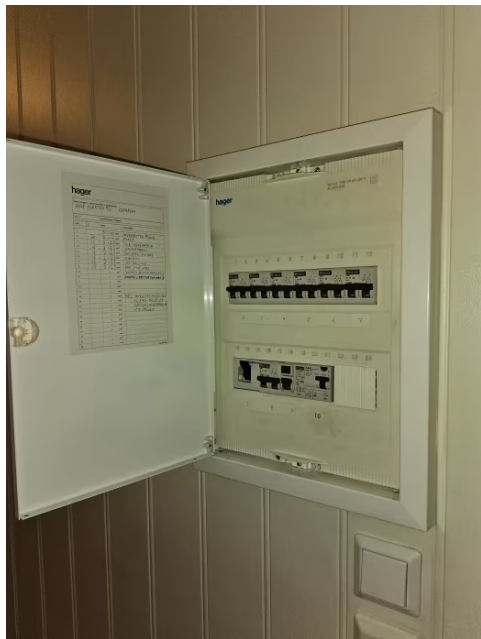
Bilde viser sikringsskap.
