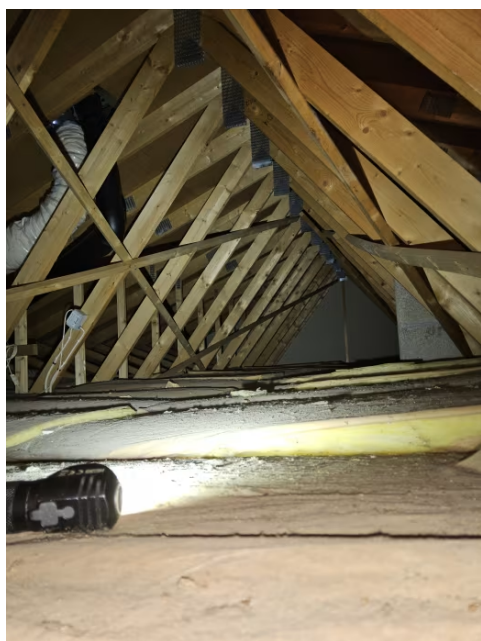
Bilde viser kaldtloft.
