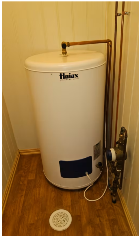
Bilde viser varmtvannsbereder.
