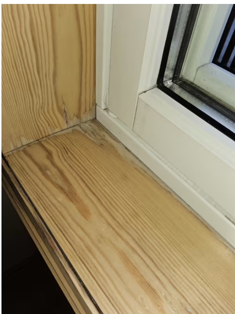
Bilde viser fukt skjolder i utforing.
