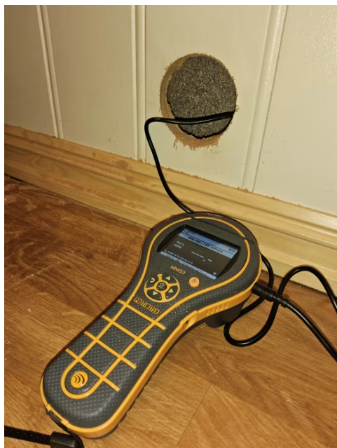
Bilde viser fuktmåling.
